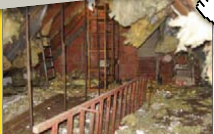
Dachboden nach Waschbär-Besuch
